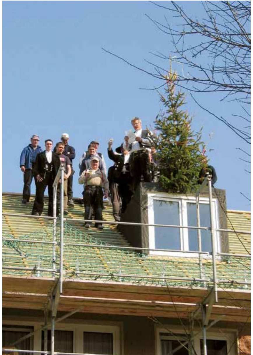
Richtfest in der Chiemgaustraße: Traditionell das Fest der Handwerker und Gewerke ist ein Richtfest natürlich immer auch ein freudiger Anlass für Studierende. Besonders in München, wo bezahlbarer Wohnraum knapp ist.
